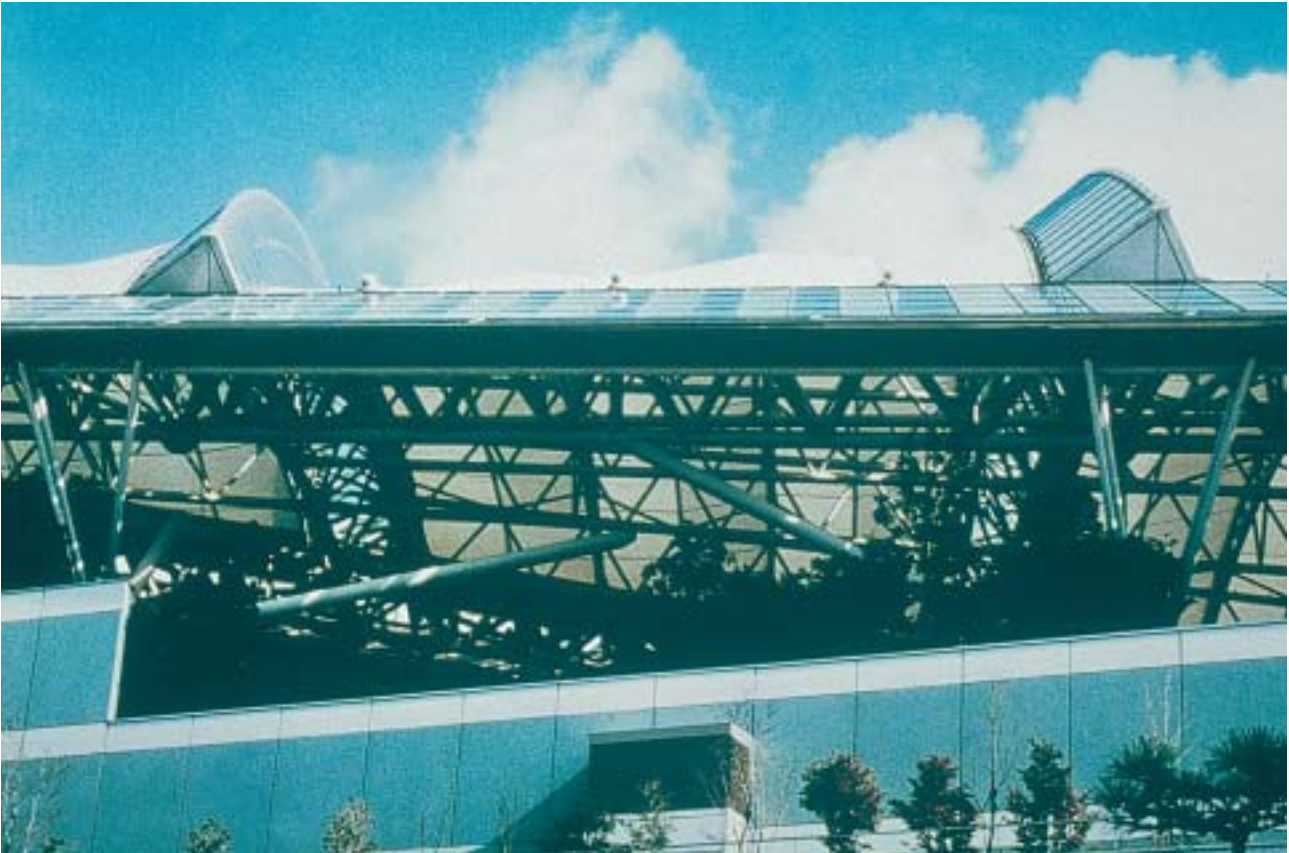
18/3 Auch diese fachwerkartige Tragkonstruktion zeigte Stabilitätsversagen von Stäben und zahlreiche lokale Schäden (Kobe Japan 1995).
