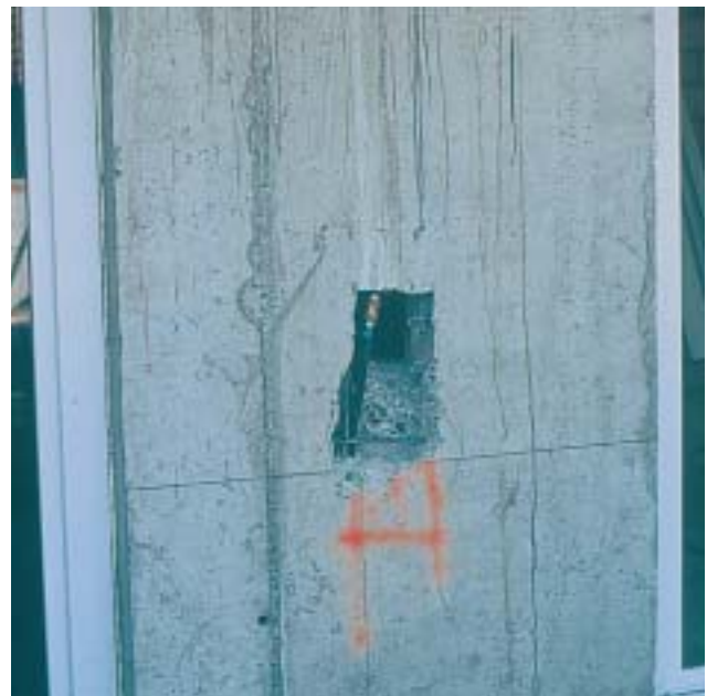
26/6 In elastisch bleibenden Bereichen des «erdbebenrelevanten» Tragwerks (hier eine kurze Stahlbetontragwand) sind je nach Umständen Öffnungen erlaubt. Eine sorgfältige Absprache mit dem Ingenieur ist jedoch unerlässlich (Schweiz 2001).
