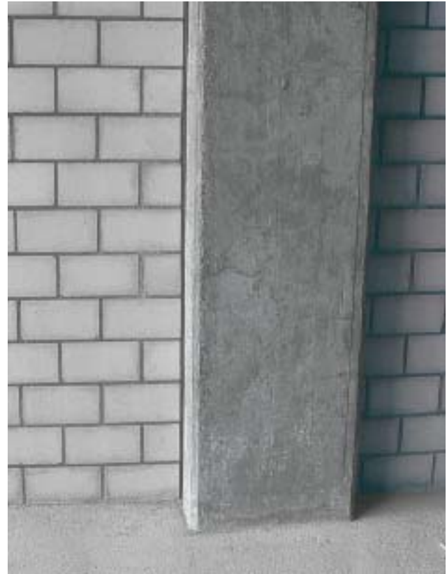
15/1 Hier wurde zwischen der Mauerwerkswand und der Stahlbetonstütze eine – wohl wesentlich zu dünne – vertikale Fuge angeordnet (Schweiz 1994).
