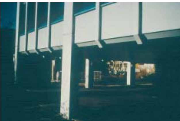
4/10 Und auch bei diesem bestehenden Gebäude sind die innerhalb der Verkleidung sehr dünnen Stützen vermutlich zu schwach. Wenige horizontal kurze Stahlbetontraggwände könnten entscheidend helfen (Schweiz 1998).
