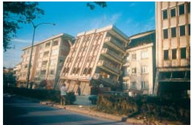
30/2 Das schief stehende Gebäude ist ungleichmässig abgesunken und lehnt sich gegen ein Nachbargebäude (Izmit Türkei 1999).
