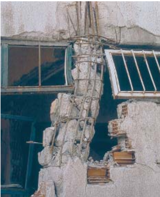
17/5 Die Stützen wiesen eine mangelhafte konstruktive Durchbildung auf (Bügel mit 90^\circ - anstatt 135^\circ -Haken und mit entsprechendem Verankerungsbruch, vergleiche Grundsatz 25). Ohne die ungünstige Wirkung der eingefügten Wände hätte sich diese Stütze aber viel besser verhalten (Izmit Türkei 1999).
