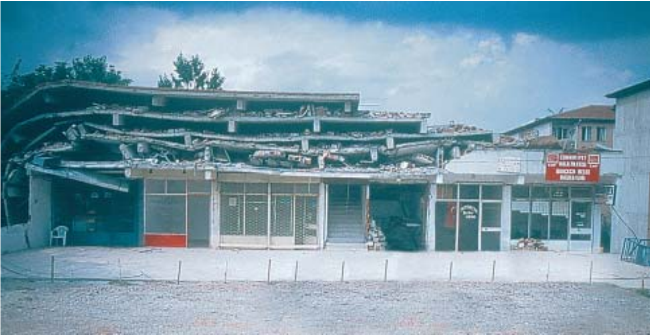
5/4 Hier waren sämtliche Obergeschosse zu weich... (Izmit Türkei 1999).
