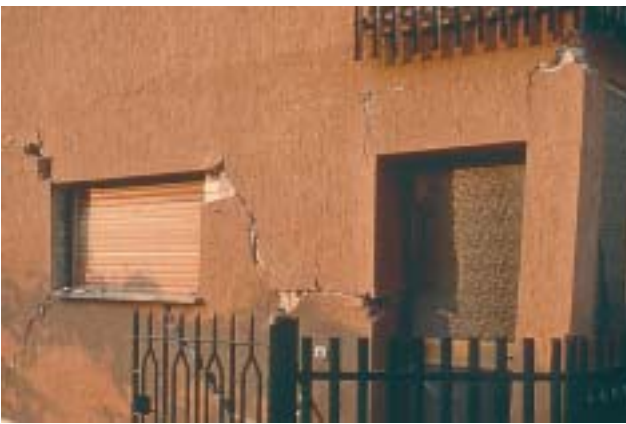
6/3 6/4 Dieses Wohnhaus war hinten an ein ähnliches angebaut mit gemeinsamer relativ fester und steifer Brandmauer. Die Fassade vorne ist wesentlich weicher, sodass Widerstands- und Steifigkeitszentrum im hinteren Bereich lagen. Das Haus hat sich im Grundriss erheblich verdreht, ist jedoch knapp nicht eingestürzt (Umbrien Italien 1997).
