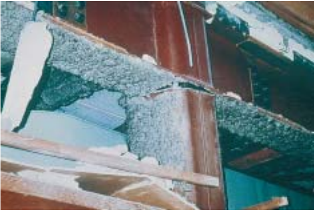
19/3 Dieses Bild zeigt einen Bruch in einem typischen Rahmenknoten; es versagte die geschweisste Verbindung zwischen der Stütze und dem Träger durch einen breiten Riss (Kobe Japan 1995).
