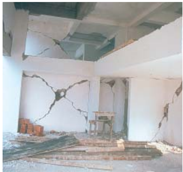
11/4 Das sind typische Kreuzrisse in Mauerwerkswänden, die in massive Stahlbetonrahmen eingefügt wurden (Izmit Türkei 1999).
