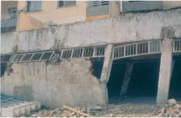
17/4 Auch hier bewirkte das Einfügen von Mauerwerkswänden mit Fensterbändern hohe Zusatzbeanspruchungen und den Bruch von Rahmenstützen. Die massive Ausbildung und das relativ gute Verhalten der Stütze rechts im Bild hat dazu beigetragen, dass das Bauwerk knapp nicht eingestürzt ist.
