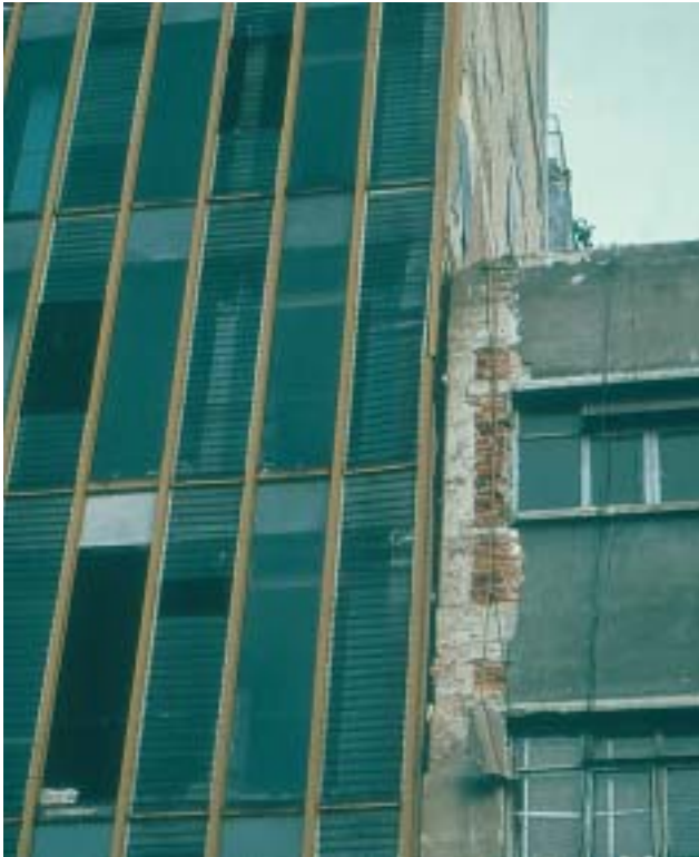
20/2 An diesen beiden sehr unterschiedlichen Gebäuden entstanden durch den Zusammenprall erhebliche Schäden (Mexico 1985).
