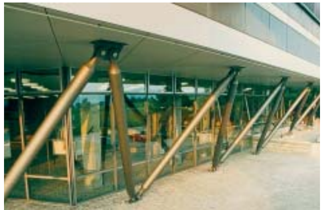
6/6 Die neuen Fachwerkstützen aus Stahlrohren fügen sich ästhetisch befriedigend in das bestehende Gebäude ein.
