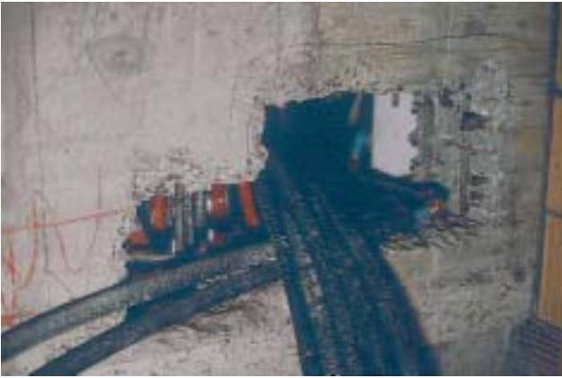
26/3 Hier wurde ein – viel zu grosses – Loch gespitzt und die Bewehrungsseisen wurden durchgetrennt. Eine mit dem Ingenieur geplante, viel kleinere Öffnung ohne Verletzung der Bewehrung und mit konzentrierten und rechtwinklig zur Wand geführten Leitungen wäre vielleicht zulässig gewesen.
