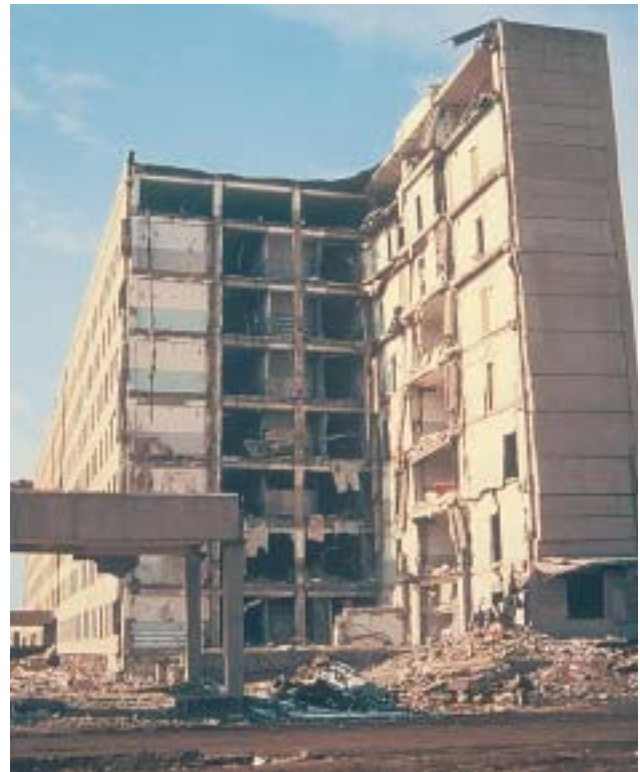
22/1 Bei diesem Gebäude ist ein Eckbereich eingestürzt. Die Decken bestanden nur aus vorfabrizierten Elementen ohne bewehrten Überbeton und ohne bewehrte Verbindungen zu den vertikalen Tragelementen (Armenien 1988).
