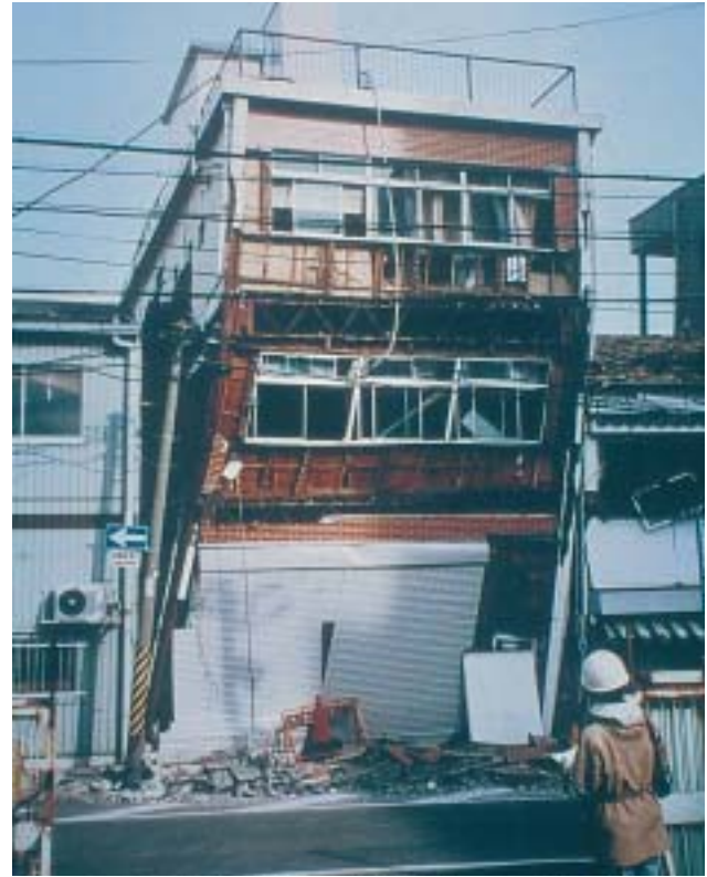
19/1 Dieser Stahlrahmen erlitt grosse verbleibende Verformungen. Vermutlich waren keine weiteren Aussteifungen vorhanden, und die Ausbildung der Knoten für zyklische Beanspruchung war mangelhaft (Kobe Japan 1995).
