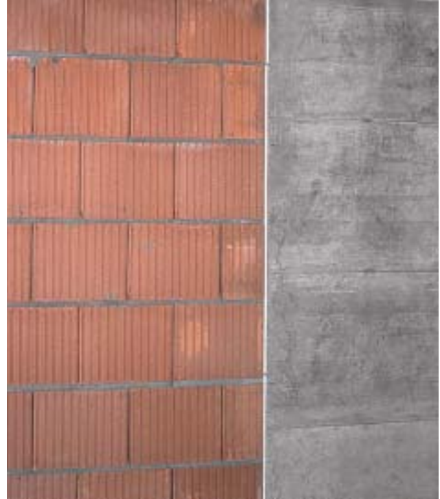
15/3 Diese Fuge zwischen der Mauerwerkswand und einer Stahlbetontragwand wurde durch Hartschaumplatten gefüllt. Hartschaumstoff ist für Erdbebenverschiebungen jedoch zu steif; ein besser geeignetes Material ist z.B. Gummischrot (Schweiz 1994).
