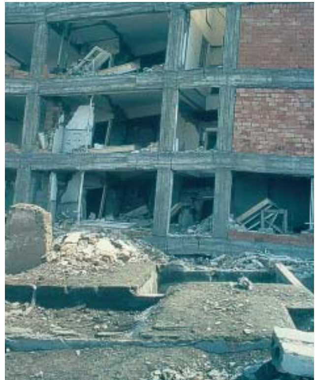
11/1 Hier waren die Stützen eindeutig stärker: Das Mauerwerk ist weitgehend herausgefallen, der Rahmen ist jedoch stehen geblieben (Erzincan Türkei 1992).
