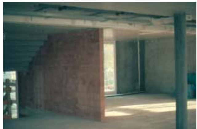
10/1 Diese tragende Treppenhauswand wird bereits bei einem relativ schwachen Erdbeben zerstört werden. Ein Totaleinsturz des Gebäudes dürfte die Folge sein (Schweiz 2001).
