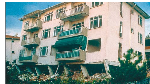
«Etage flexible»: les parois de contreventement sont interrompues au rez-de-chaussée. Ce point faible est fréquent en Suisse.
