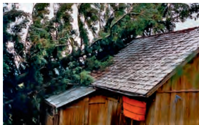
Exemple de dommage dû à la chute d'un arbre.
