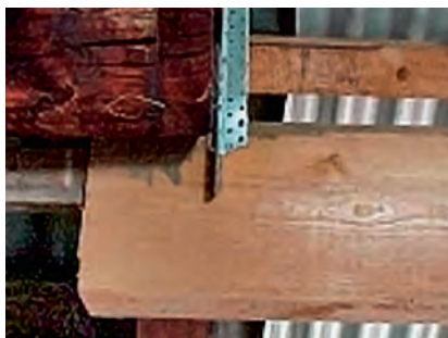
Transformation avec des liaisons sous-dimensionnées.
