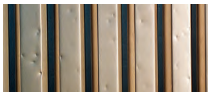
Les photos suivantes présentent des dégâts subis par des tuiles en tôle. Elles révèlent des bosses, ain-
