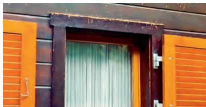
Dommages structurels par arrachement d'angles exposés
