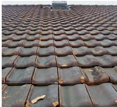
Éclatements sur la face supérieure des tuiles.
