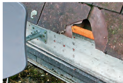
Éclatement de plaques en fibres-ciment.
