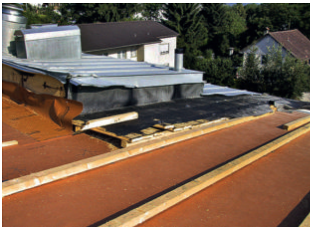
Pour ce toit en tôle profilée, on a utilisé des clous lisses plutôt que des vis (ou des clous rainurés ou torsadés). Lorsqu'une rafale de tempête l'a touché un beau jour,
