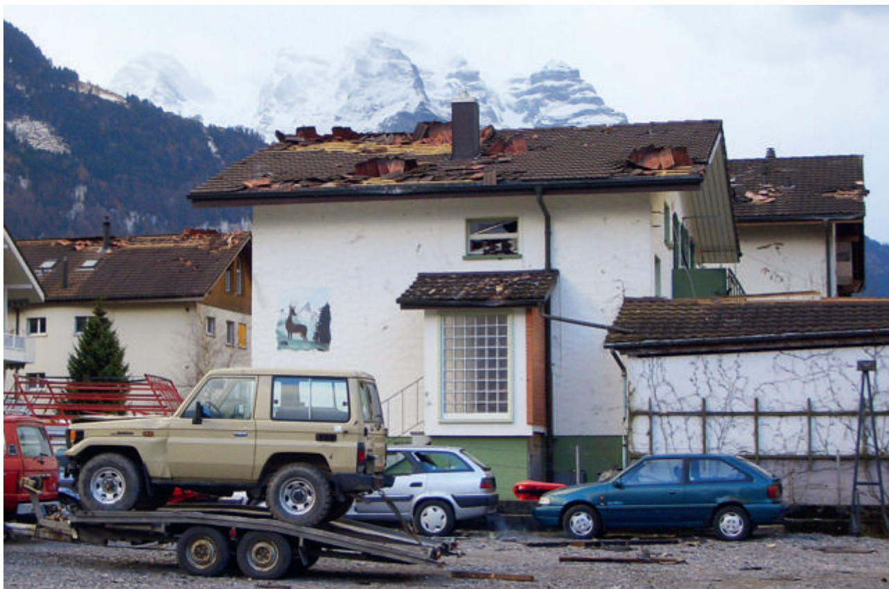
Image classique d'un dommage collectif: plusieurs bâtiments endommagés à Dallenwil, dans le canton de Nidwald (12 mars 2008; voir aussi page 45). Photo: Nidwaldner Sachversicherung
