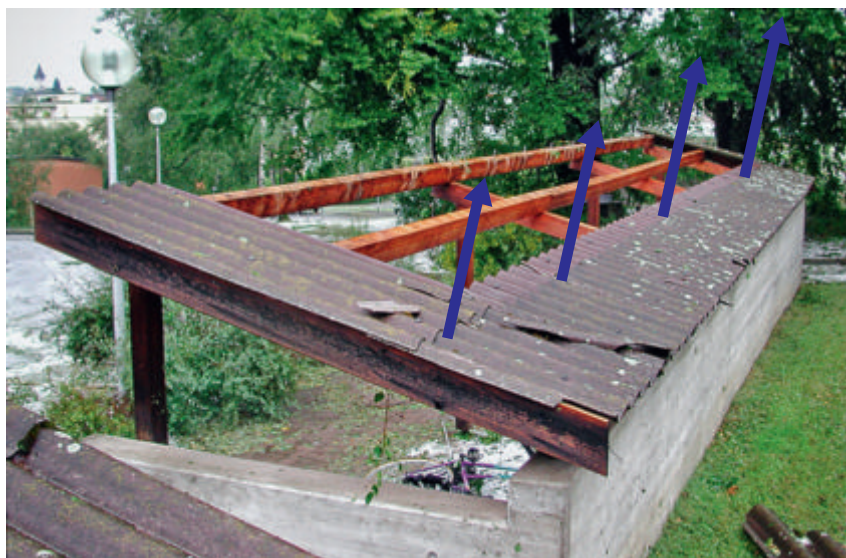
Les abris, comme les avant-toits, peuvent subir des dommages considérables lorsque leur face supérieure est sujette à une succion et que leur face inférieure est soumise simultanément à une pression de même direction. Photo: Etablissement cantonal d'assurance d'Argovie
