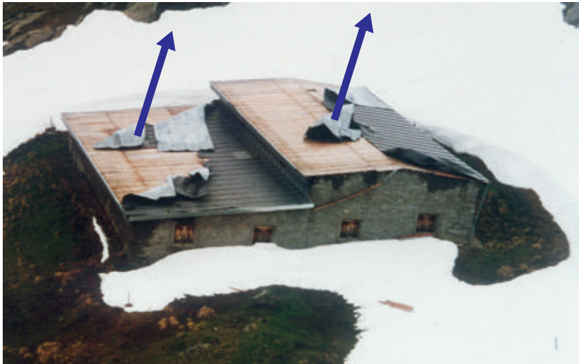
Un toit en tôle profilée déchiqueté par les rafales d'une tempête. Photo: Etablissement cantonal d'assurance des Grisons
