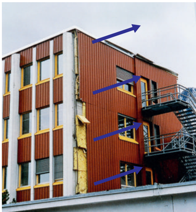
Façade endommagée par une tempête à l'angle du bâtiment, suite à la pression régnant à l'intérieur de la façade (non dessinée) et à la succion externe qu'elle a subie (flèches bleues). Photo: Etablissement cantonal d'assurance de St-Gall
