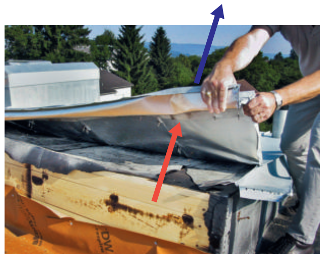
les forces de succion ont été assez fortes pour arracher les clous. Source: [09]. Photos: Etablissement cantonal d'assurance d'Argovie
