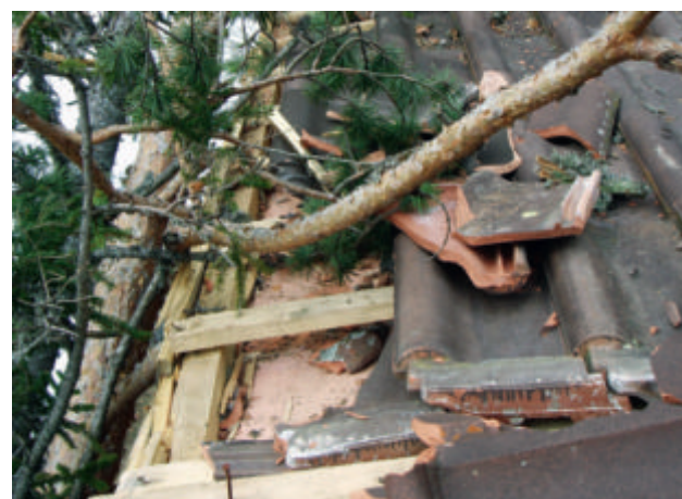
Un arbre a raclé le bord du toit d'un bâtiment voisin en tombant.
