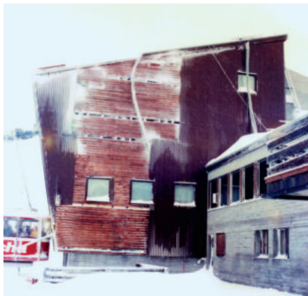
Façade d'une station supérieure de téléphérique endommagée par une tempête. Photo: Etablissement cantonal d'assurance des Grisons
