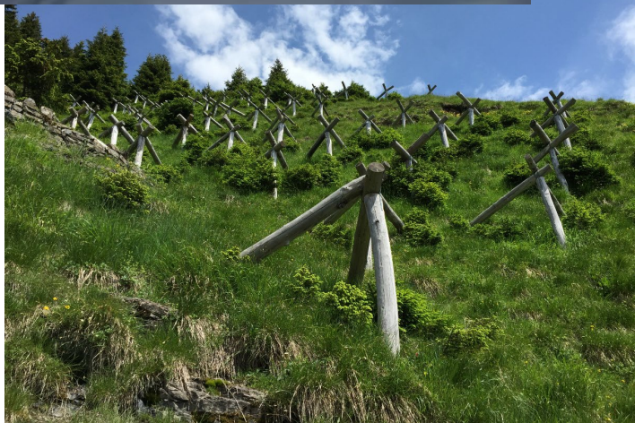
Ouvrages temporaires contre les départs d'avalanches (en haut) et contre les glissements de neige (en bas)
